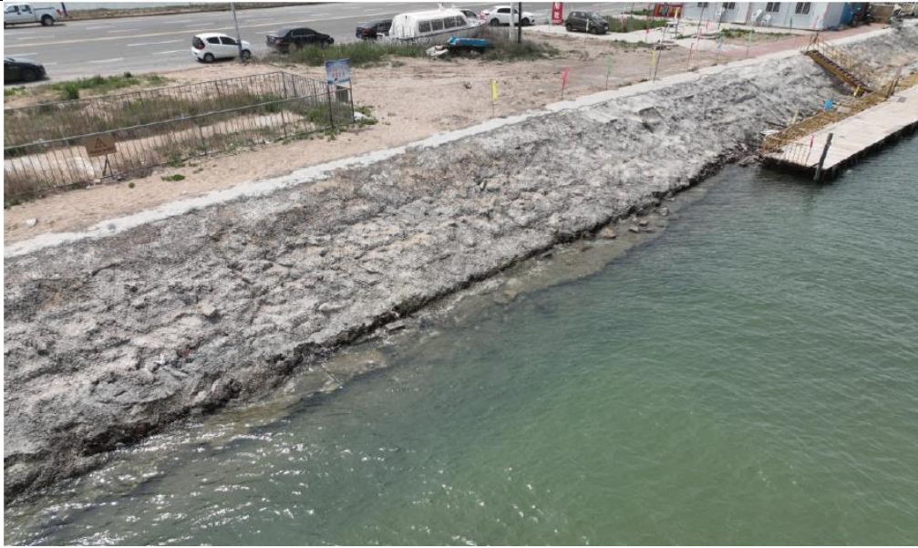
图 1.3.1-2 老米沟浆砌石护岸现状
