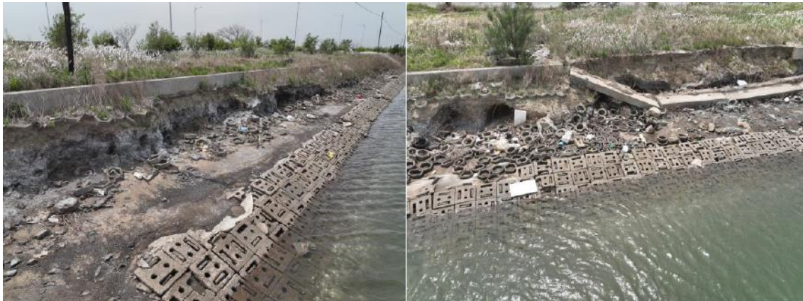
图 1.3.1-3 老米沟破损护岸现状
